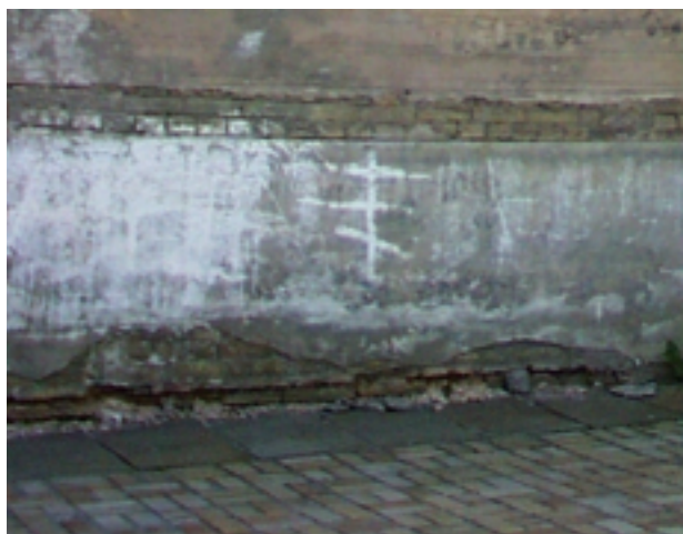
Вплив цементної штукатурки та вологи на стан цоколя
